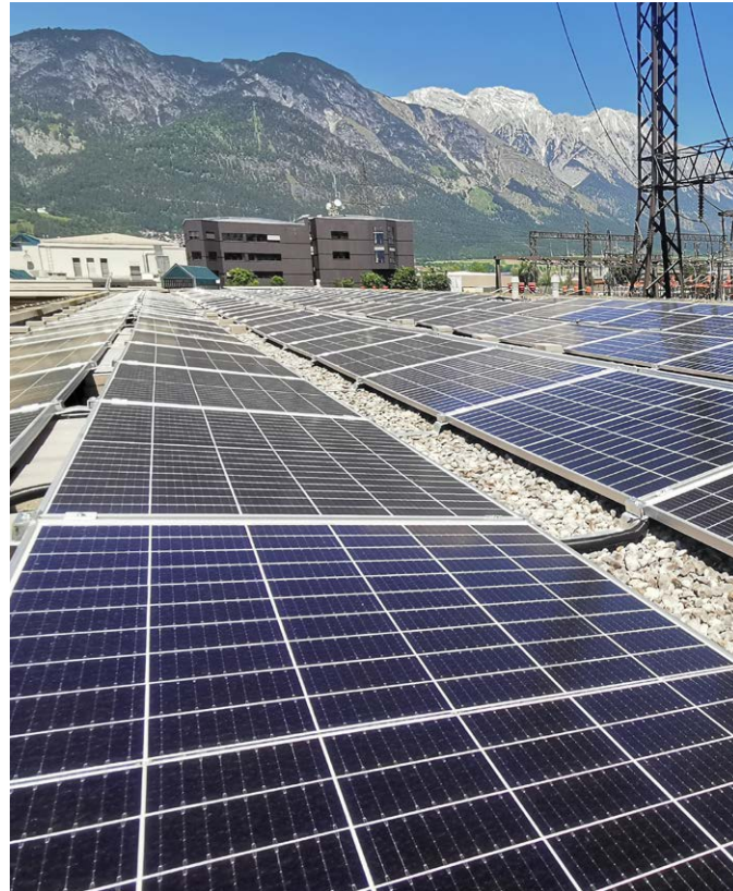
Aufgeständerte Ost-West Ausrichtung auf einem Flachdach
