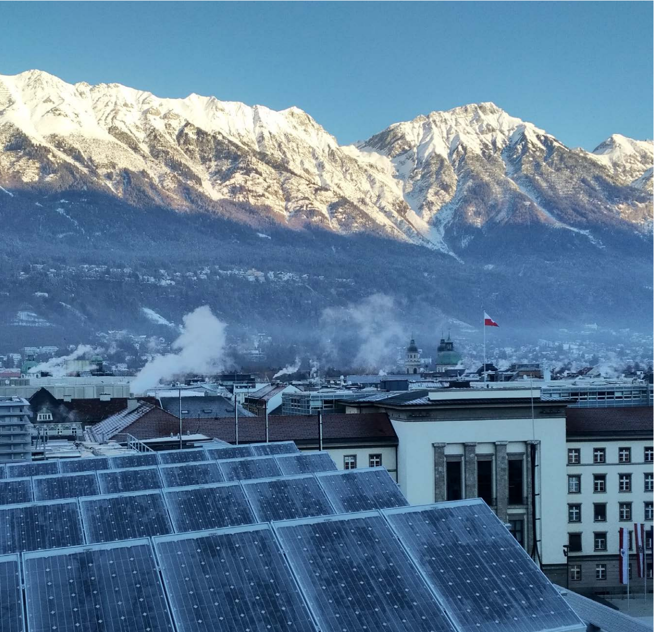
Aufgeständerte Südausrichtung auf einem Flachdach
